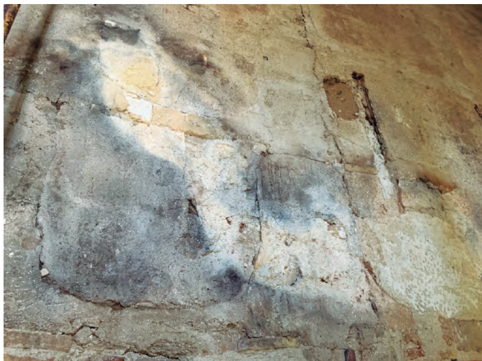
Fig. 14. Huellas de incendio en el muro del refectorio, junto a la salida al claustro. Fotografía: autor (Archivo Arqueología Municipal Zaragoza).
